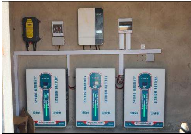
Figure 22:disposition des batteries pour l'énergie solaire(source : Lucien KOFFI lors de la visite chantier)
