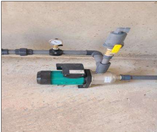
Figure 23: image du supprimeur pour la gestion de la pression (source : Lucien KOFFI lors de la visite chantier)
