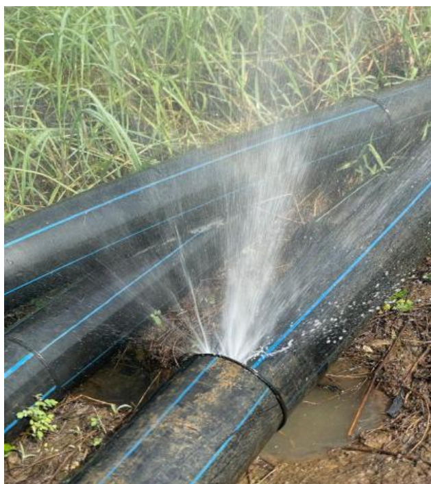
Fuite constatée sur un PEHD 200mm
