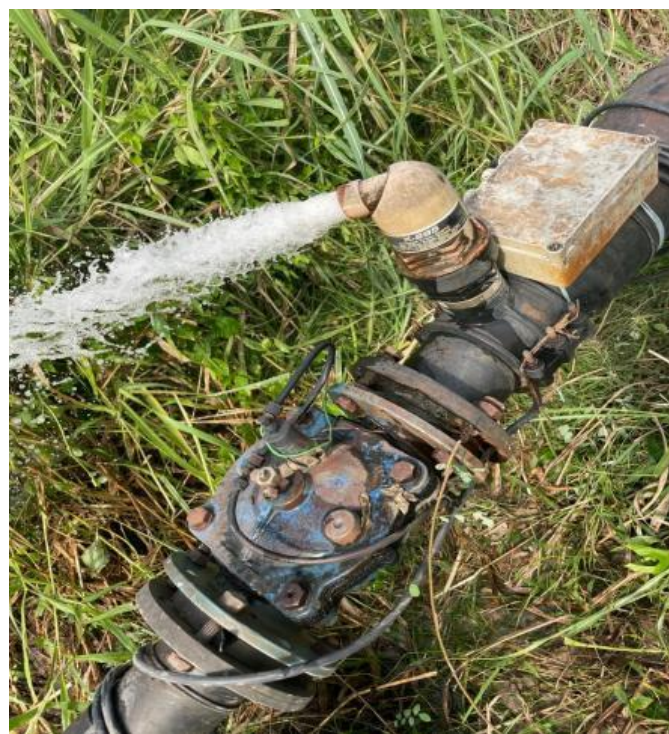
Une ventouse défectueuse
