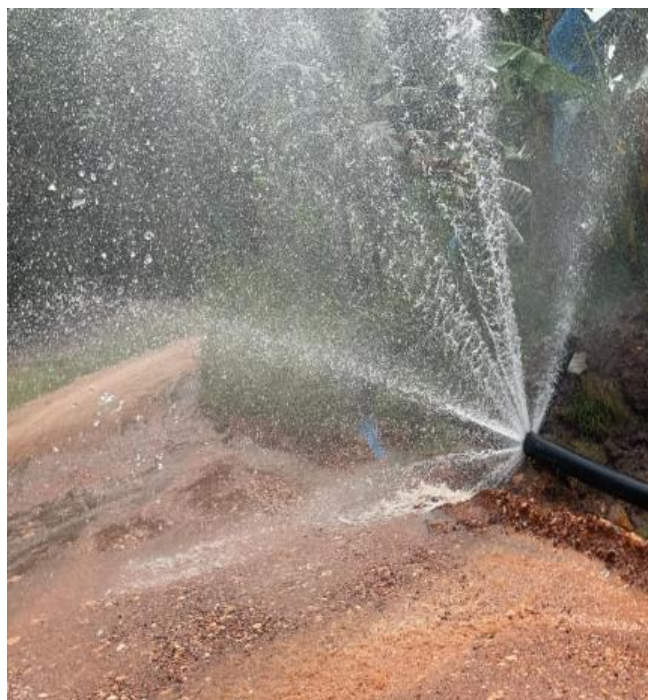
Fuite constatée sur un PEHD 110mm
