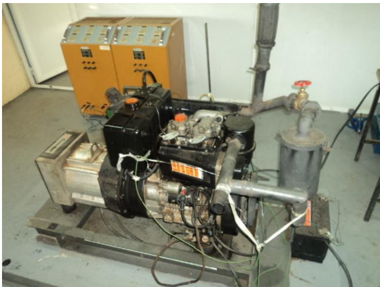
Photo 1 : groupe électrogène couplé aux bancs
