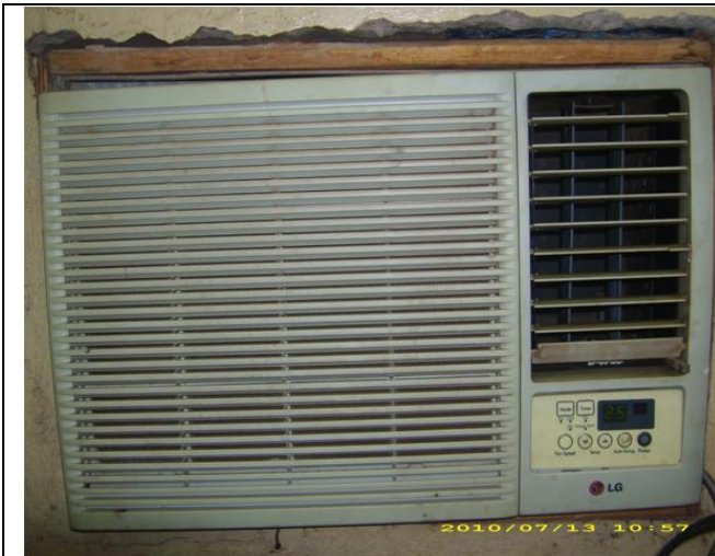
Figure 8: Climatiseur en salle des électriciens
