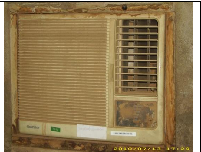
Figure 9: Climatiseur en local batteries
