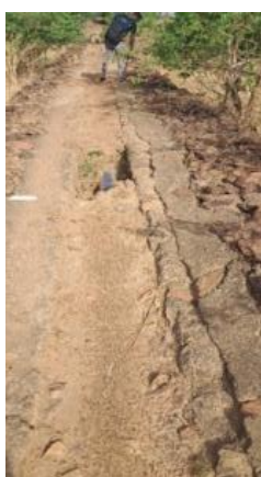
Figure 16 : CP2 bouché sur 80m et complètement hors usage
