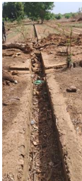
Figure 9: canal secondaire avec prise tertiaire
