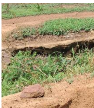
Figure 19: Canal dégradé sous pression des terres sur 40% du CP1
