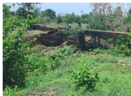
Figure 21: Pont canal du CP2 dégradé à 85%
