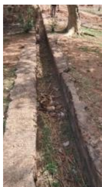
Figure 20: déstabilisation du CP1 à 70% sous pression des racines des arbres
