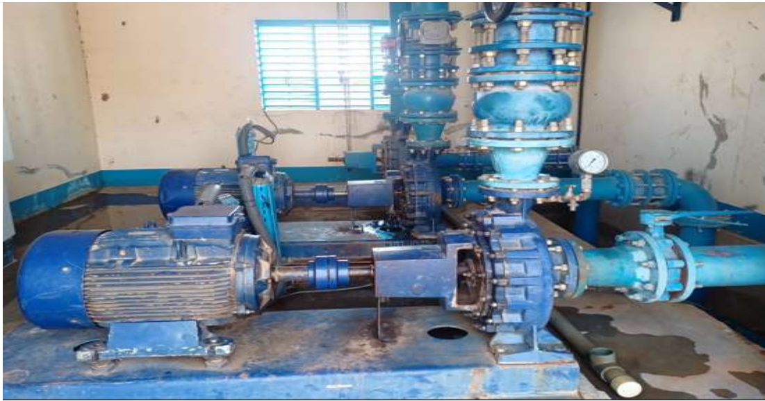
Figure 6: Pompes de la station de pompage de Boudtenga
