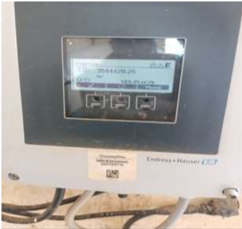
Figure 3 : Débitmètre de la station de Boudtenga
