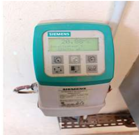
Figure 4 : Débitmètre de la station de Guilingou
