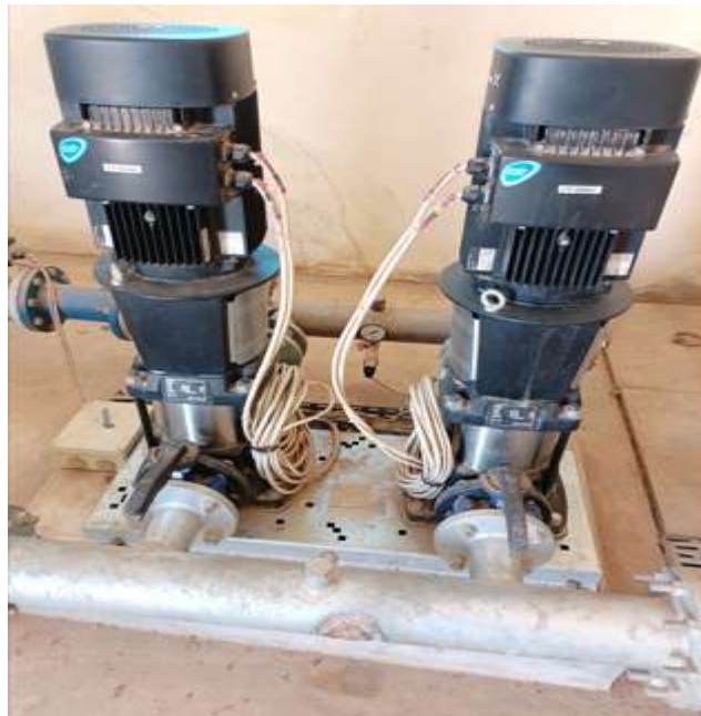
Figure 7: Supprimeur au niveau de la bache de Guilingou
