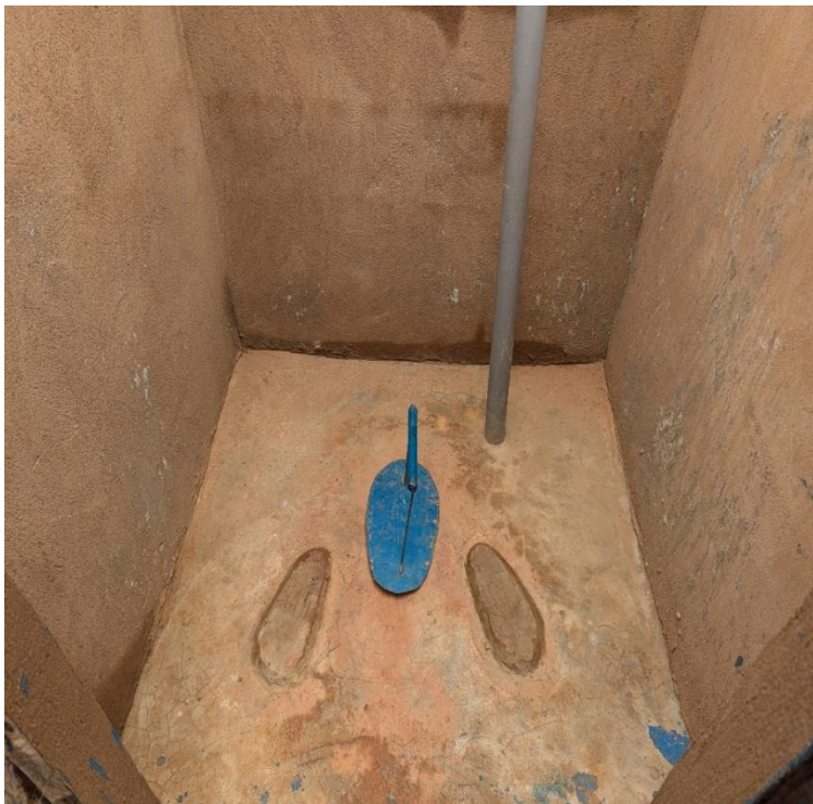
L'intérieur de la latrine munie d'un couvercle sur le trou de défécation
