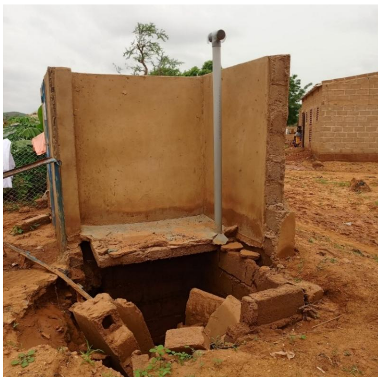
Figure 23 : Effondrement de la superstructure et de la dalle d'une latrine
