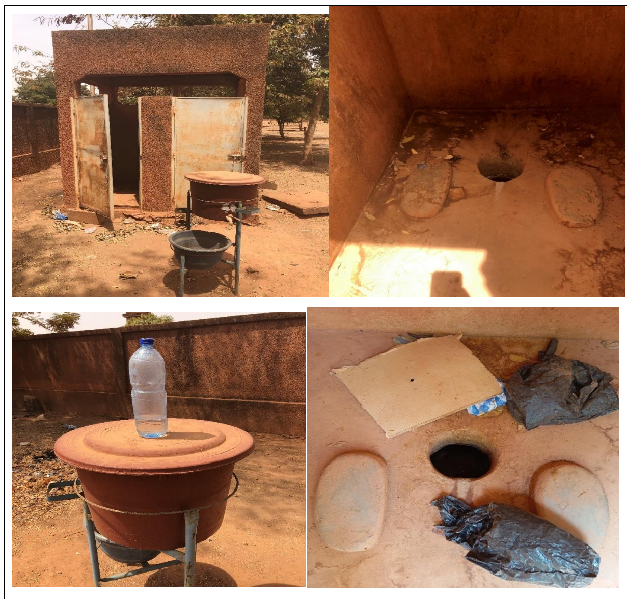
FIGURE 5 : ETAT DES LATRINES DES PATIENTS DU BATIMENT 1 (FELICIA, 2024)
