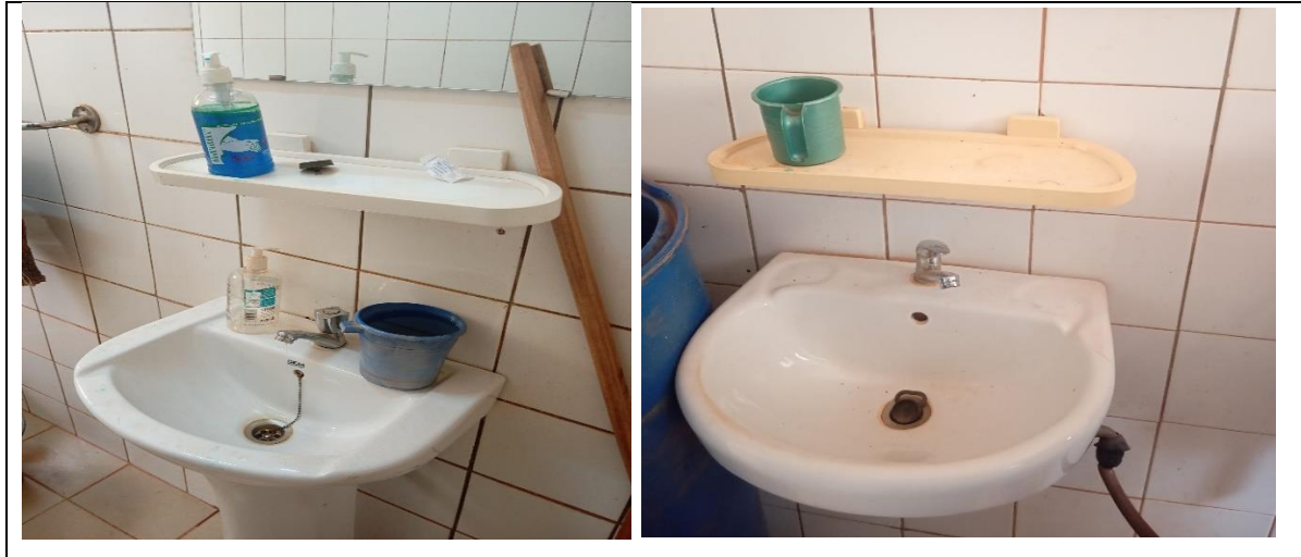
FIGURE 6 : ETAT DES TOILETTES DU PERSONNEL DU BATIMENT 2 (FELICIA, 2024)
