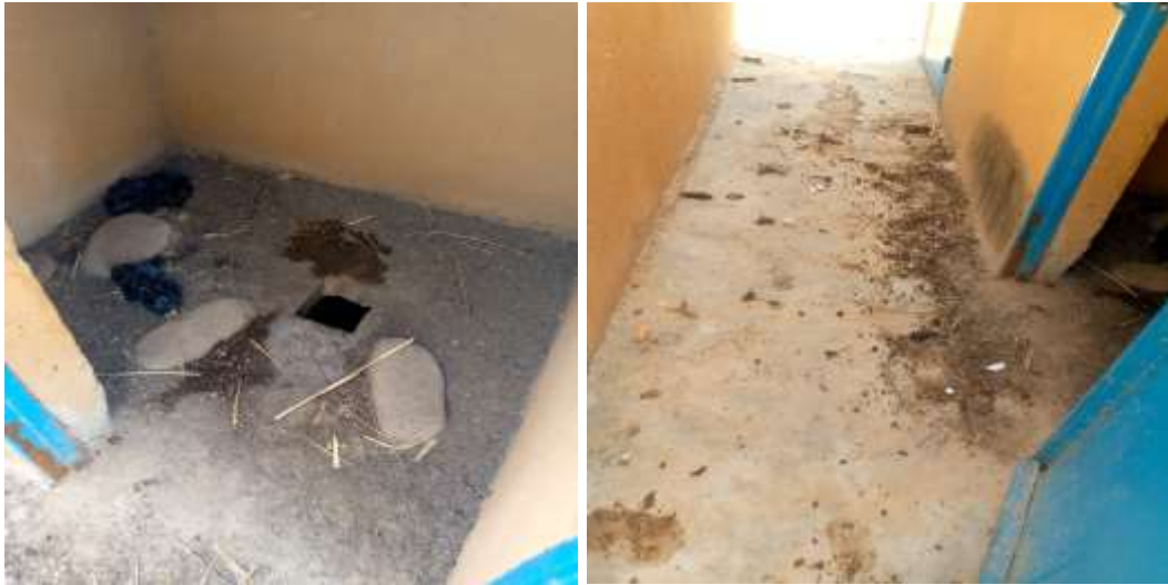
Photos 4 : Mauvaise utilisation et gestion des latrines sur les sites de PDI
