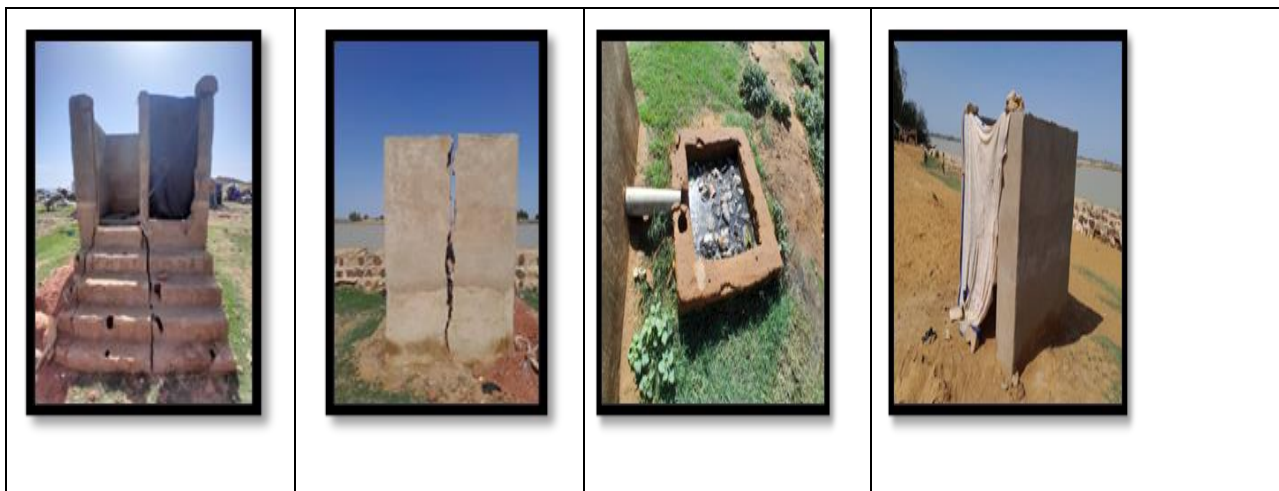
Figure 19 : Toilettes endommagés sur le site
