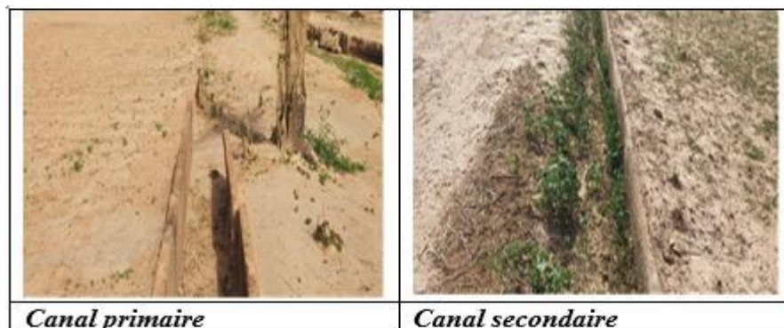
Figure 10 : Aperçu des dégradations sur les canaux primaires et secondaire
