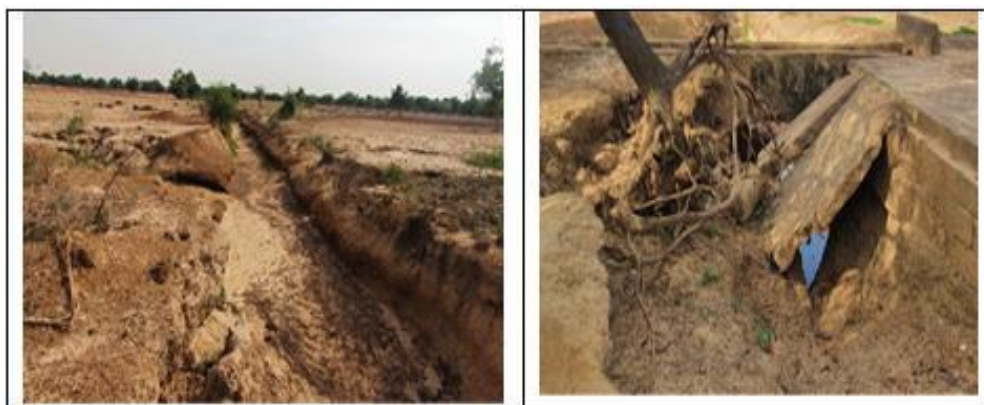
Figure 11 : Etat des dégradations du drain collecteur et des ouvrages de franchissement
