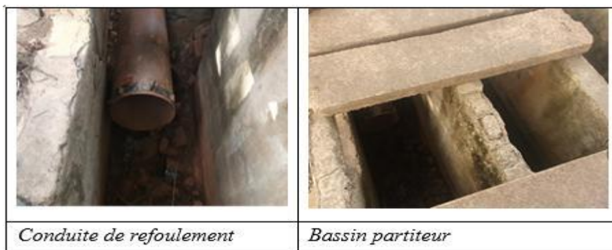
Figure 9 : vue d'ensemble de la conduite de refoulement et du bassin partiteur
