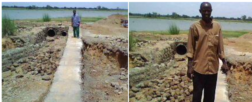
Photo2: Canal d'évacuation d'eau endommagé sur le Barrage d'Arzoum Baougo(Boussouma)
