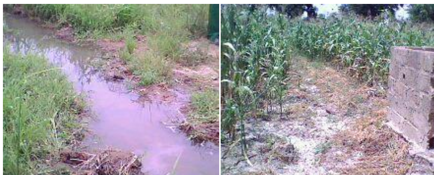
Photo 3 : Conduit en terre en débordement Sur le périmètre maraîcher de Boussouma et Canal en terre ensablé sur le site de petite irrigation de Boussouma
