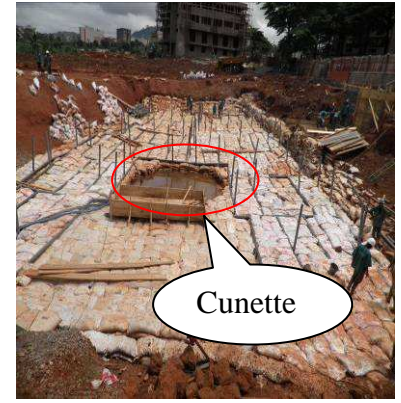
Ouvrage d'évacuation et de prélèvement des eaux traitées
