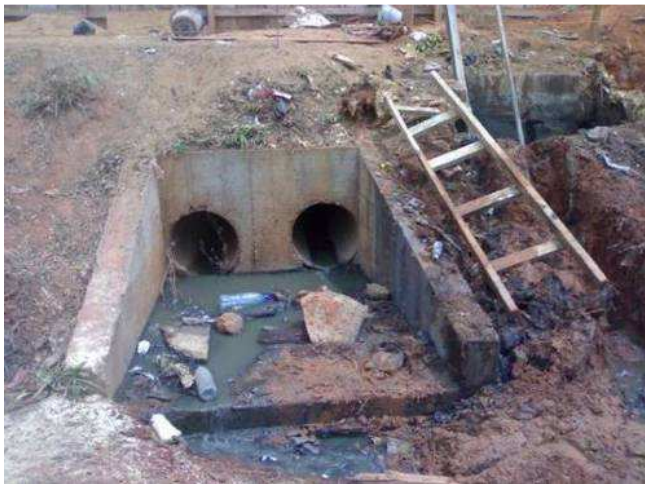
Eaux usées à l'entrée de l'ancienne station d'épuration
