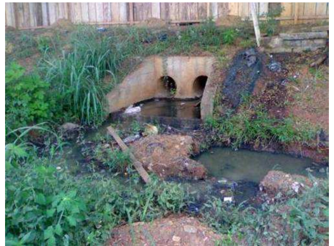
Eaux usées répandues un peu partout sur la zone d'étude
