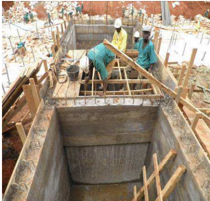
Ouvrages de prétraitement
