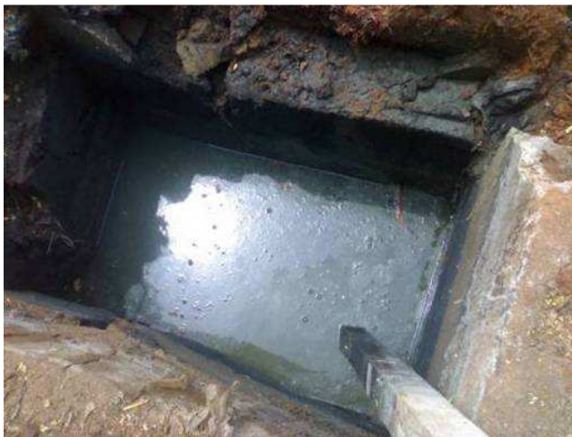
Caniveau d'évacuation des eaux pluviales remplie d'eaux usées
