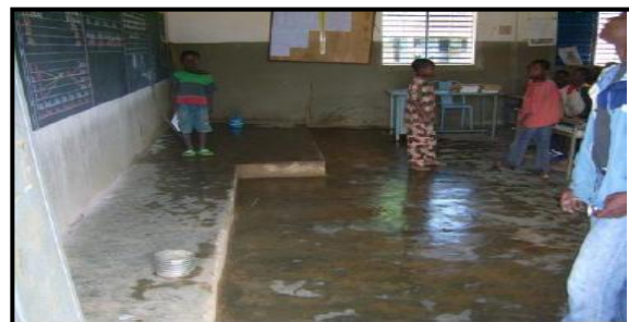
Photo 12 : Mobilier scolaire détérioré
