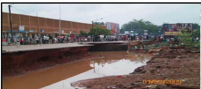
Photo 1:Etat d'une route dégradée
