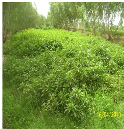
Photo 8 : Drain envahi par la végétation
