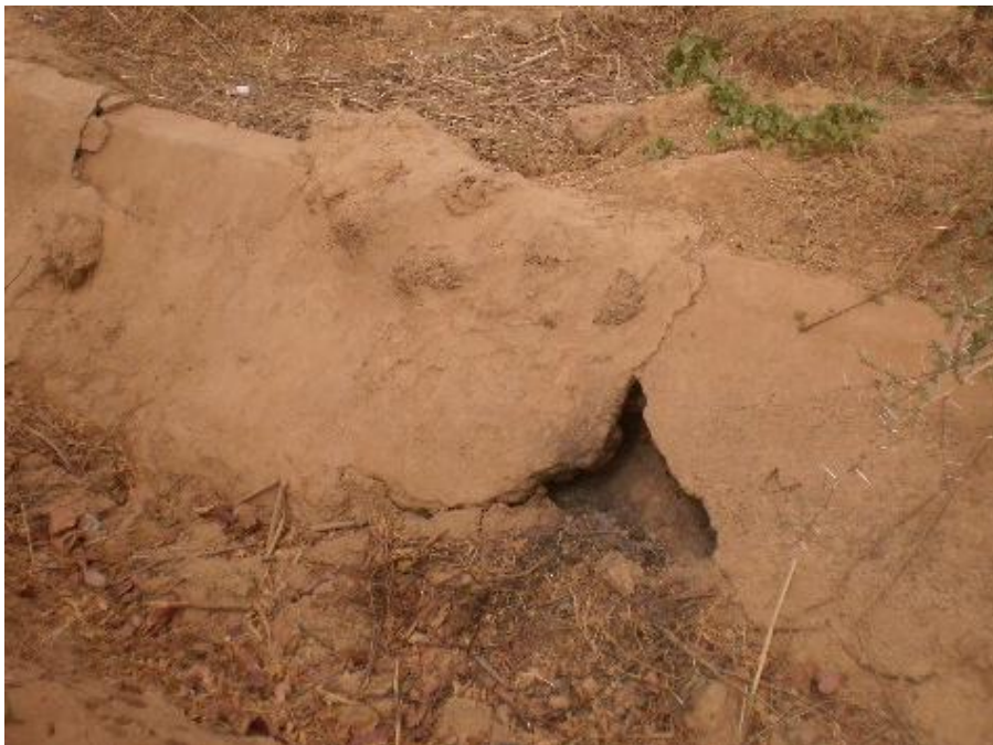
Figure 11 : Etat de dysfonctionnement du canal primaire
