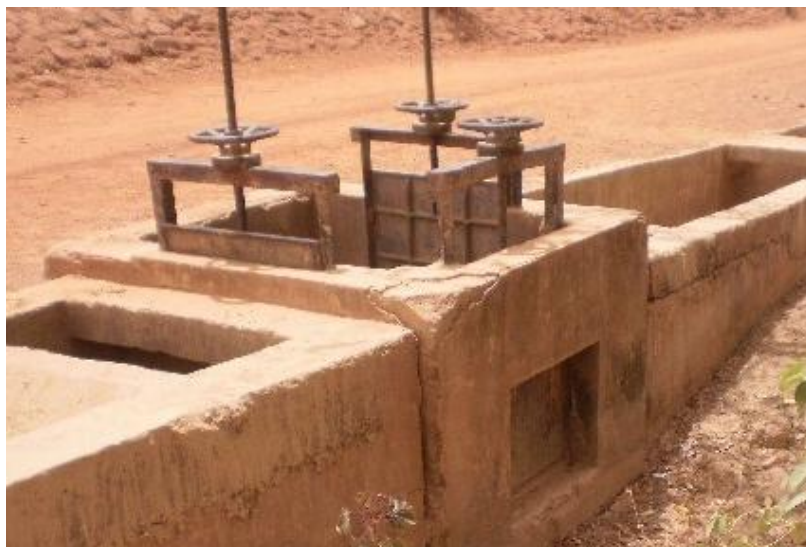
Figure 10 : Le bac de répartition
