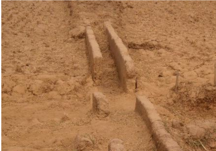
Figure 12: Etat d'un canal secondaire
