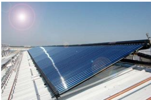
Figure III-4: Capteurs à tubes sous vide sur la Marina de Venise, Italie (Source de la photo : Climatewell)
