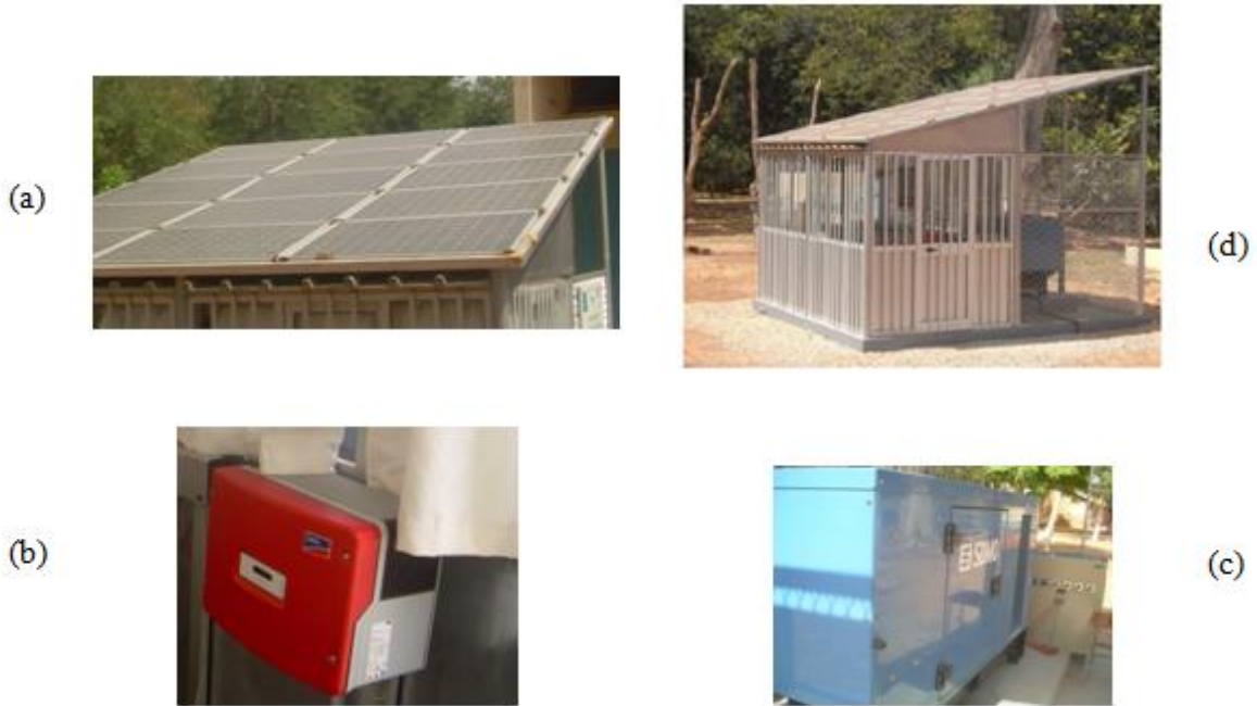
Figure 15: (a) modules PV, (b) Sunny Boy (onduleur monophasé), (c) groupe électrogène triphasé de 11,5 kVA, (d) local du prototype
