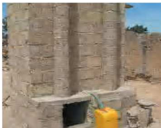
Photo N°9 latrine Ecosan (recueil des urines)
