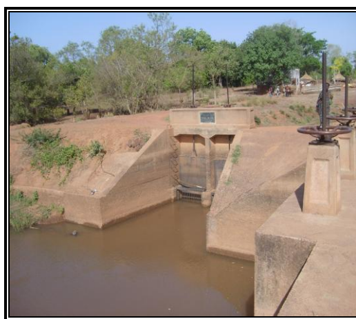
Prise d'eau du Kou à Diaradougou
