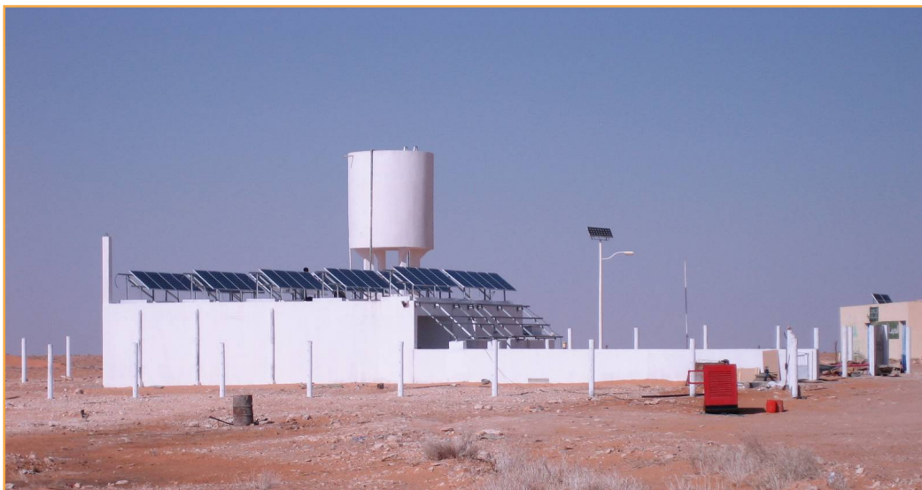
Vue du bâtiment qui abrite l'installation du projet en Ksar Ghilène
