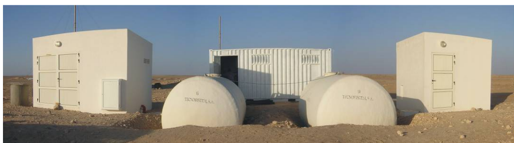
Vue générale de l'installation d'une unité de dessalement dans le village de Ten Alloul
