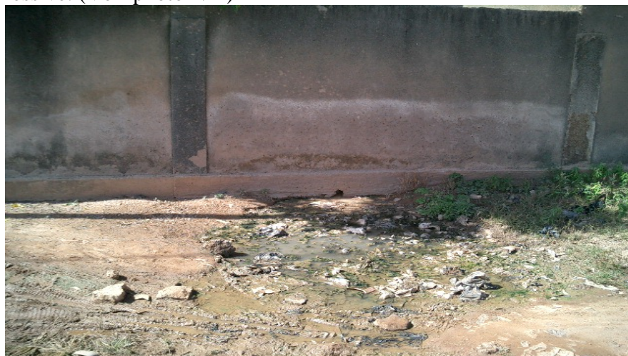
Photo 1: Rejets des eaux de toilette dans la rue
