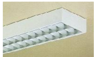
Figure 5: exemple 2 de luminaire
