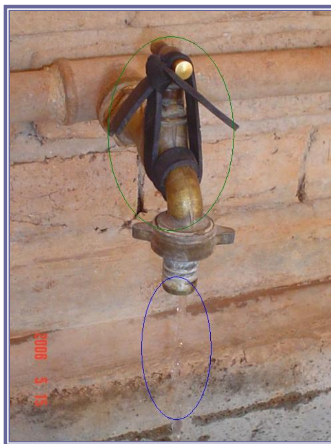
Photo 10 : Fuites sur robinet classique à joint
