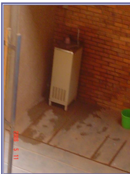
Photo 5 : BF avec fortes fuites à l'utilisation
